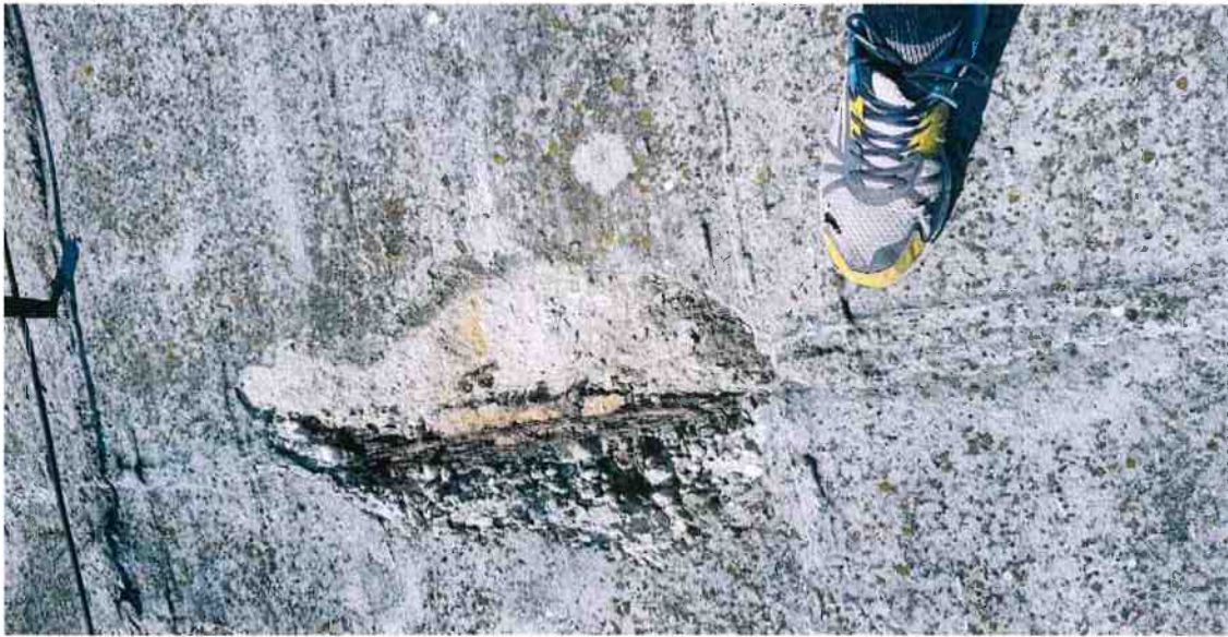
ručně obnažená výztuž - viz video
