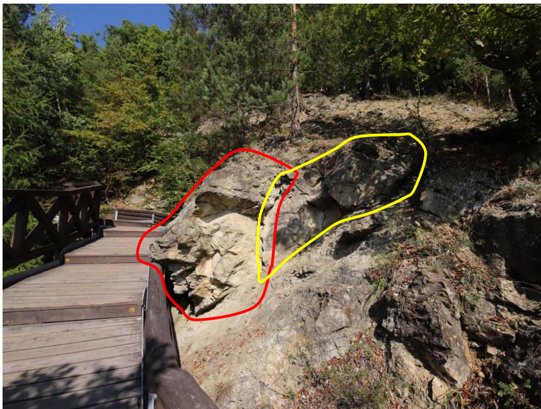
Obrázek 14: vymezení labilního bloku – červeně, který zatěžuje konstrukci stezky, nasedající bloky – žlutě, bloková struktura je labilní a velmi riziková s potenciálem destrukce konstrukce stezky
