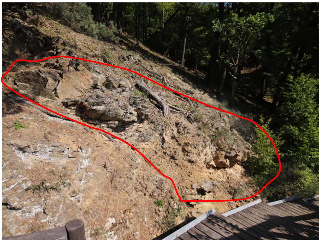
Obrázek 16: silně zvětralé partie masivu v km 0,533 - 0,540
