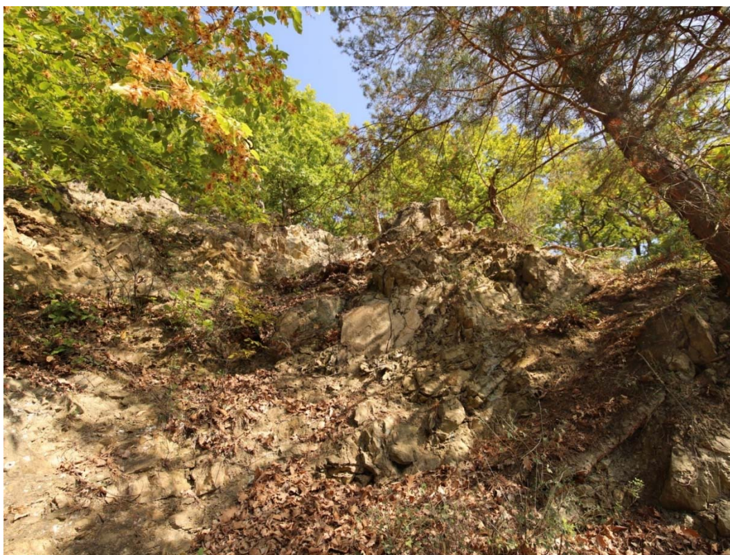
Obrázek 11: spodní pohled na rizikovou oblast tvořenou zvětalým výchozem skalního podkladu, opad v podobě drobných fragmentů
