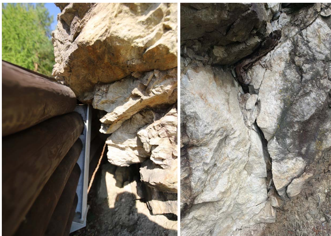
Obrázek 15: detail nasedání bloku na konstrukci stezky a detail rozevřené pukliny bloku, více jak 22 mm
