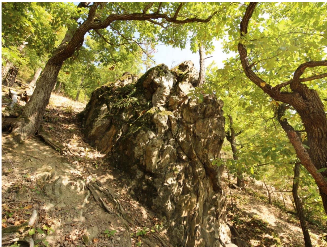
Obrázek 8: detail blokového výchozu masivu nad stezkou v km 0,472, nutný pouze maloplošný zásah očištění od volných částí
