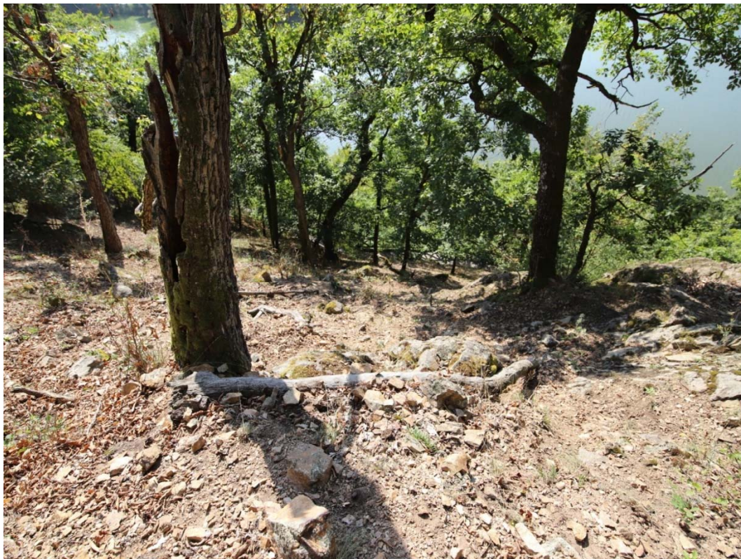
Obrázek 26: povaha krytu svahu s výrazným erozním narušením, bez možnosti zadržování většího množství suti
