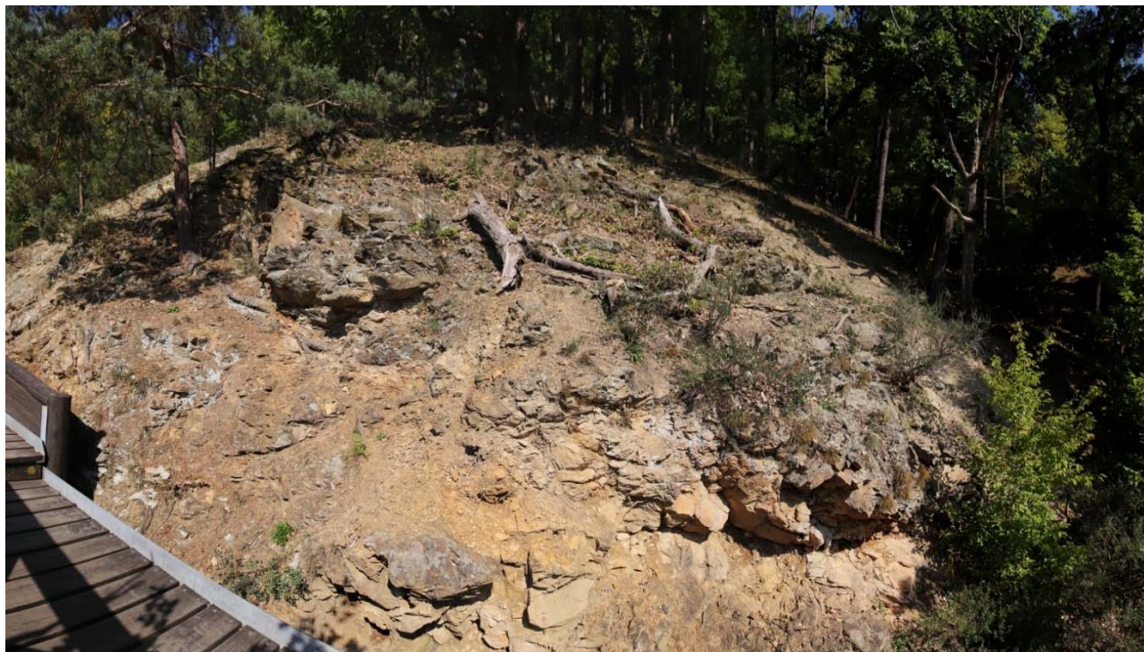
Obrázek 17: celkový panoramatický pohled na rizikové zvětralé partie svahu v km 0,530 – 0,540
