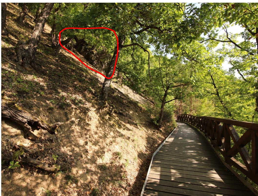
Obrázek 7: vazba pozice blokového výchozu masivu nad stezkou v km 0,472
