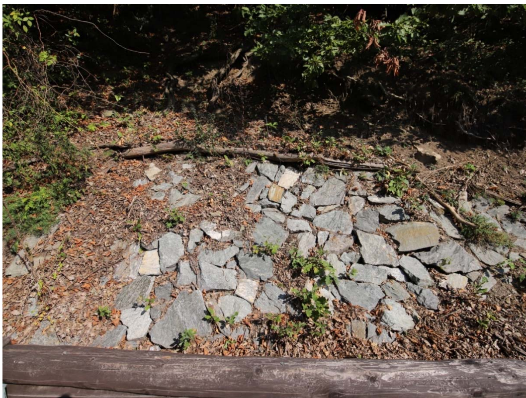
Obrázek 41: detail kamenné rovnaniny v patě svahu s velmi silným erozním narušením výše položeného svahu
