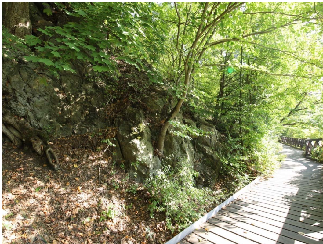
Obrázek 39: pata výchozu bloku u stezky, rizikové bloky jsou kryty křovinatou a náletovou vegetací ve výšce cca 2 – 4,5 m nad stezkou
