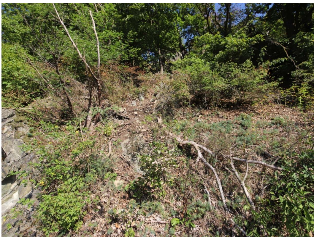
Obrázek 43: příklad masivního erozního narušení svahu v km 0,760 – 0,770
