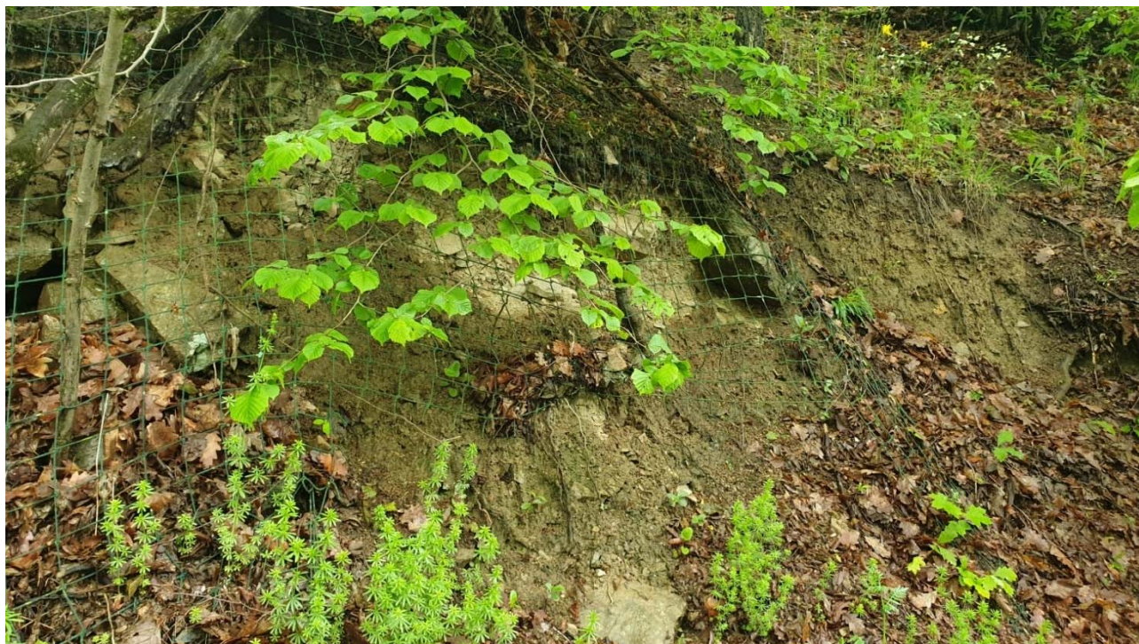
Obrázek 32: detail stavu a nulové ochranné funkce textilních sítí v patě svahu
