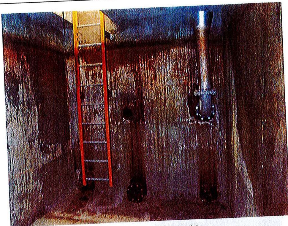
Stěna do armaturní komory – chybné průchodky potrubí
