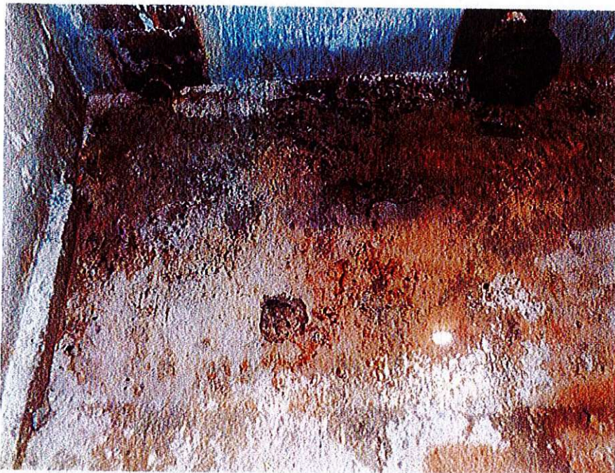
Dno – degradace, změknutí
