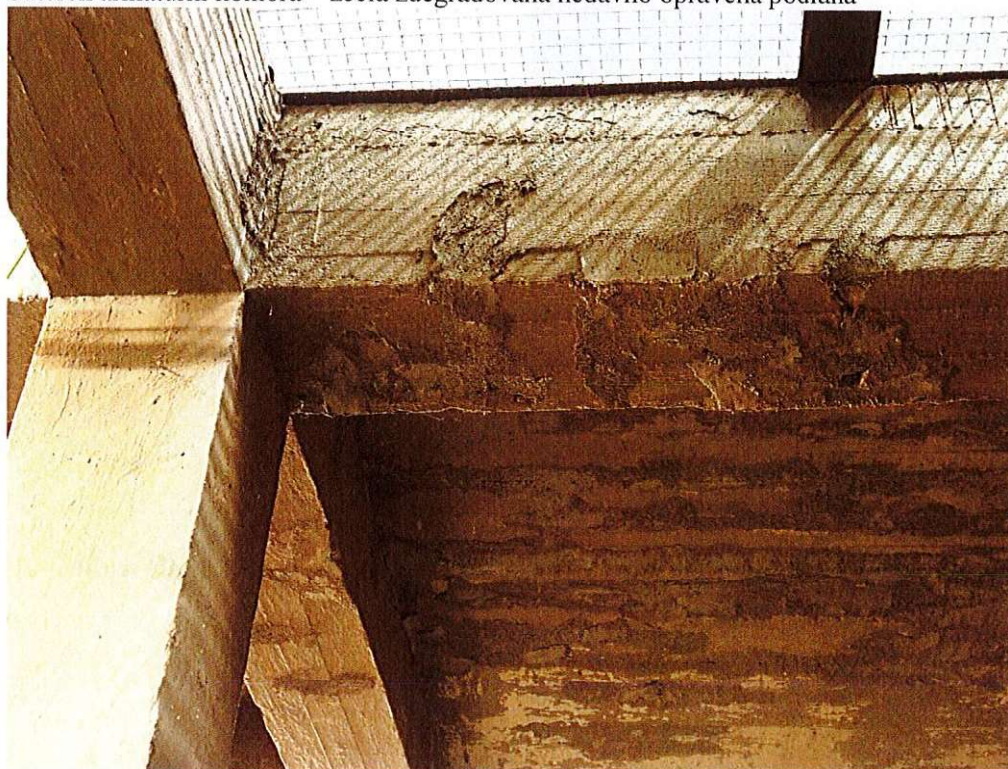
Žb strop nad armaturní komorou – degradace betonu, koroze výztuže
