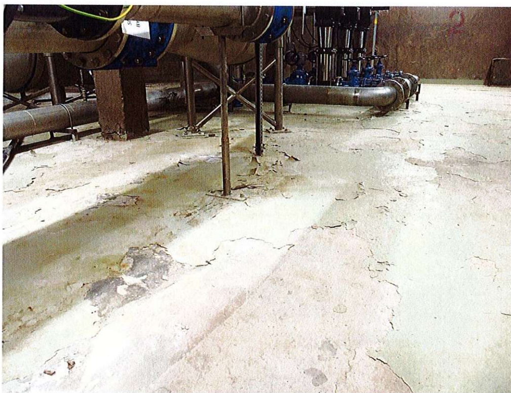
Suterén armaturní komora – zcela zdegradovaná nedávno opravená podlaha
