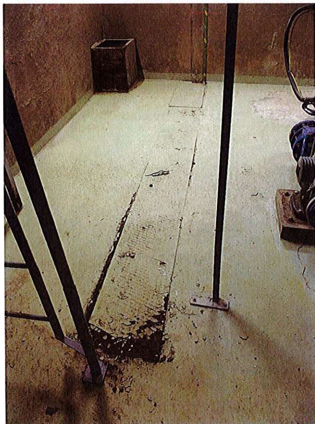
Nefunkční elektro zemní kanály zrušit
