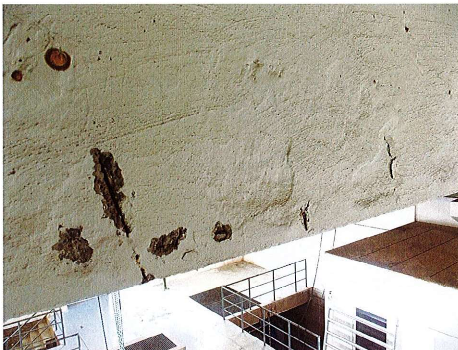
Stropní průvlak – počínající koroze, nekvalitní provedení
